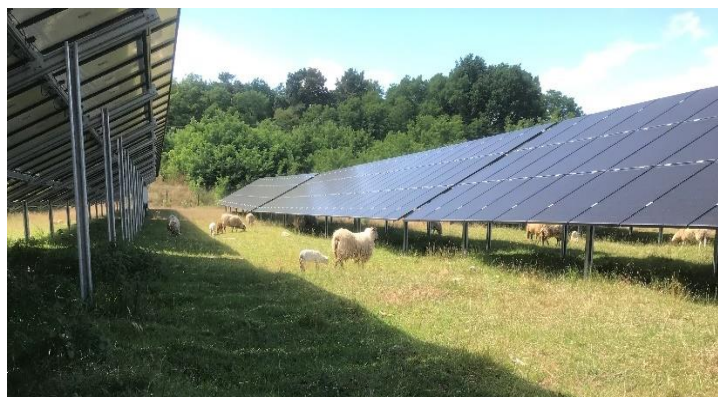
Abbildung 6: Extensive Schafbeweidung im Solarpark
